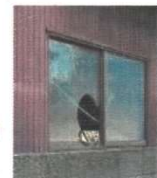
窓が割れた管理不全空家
