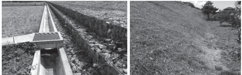
勝浦川破堤対策整備済み区間(左)と危険な未整備区間(右)
