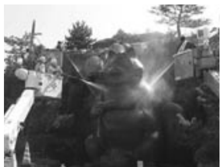
高圧洗浄機で清掃する四国電力グループの社員ら
