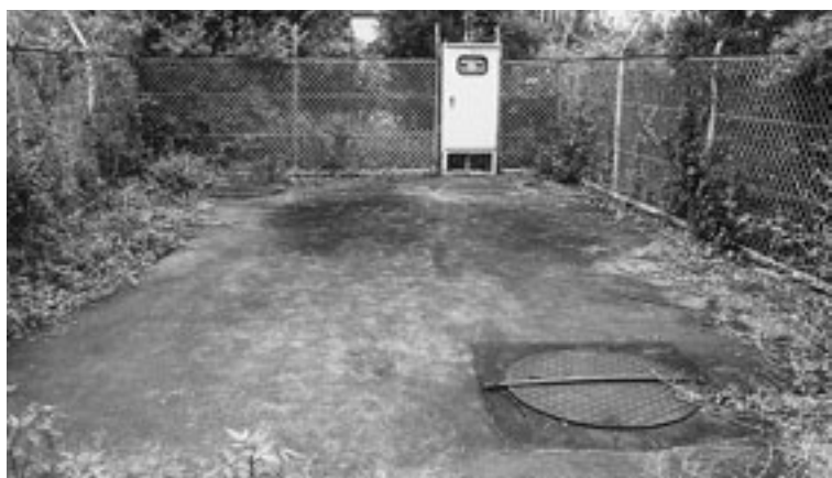
和田島町松田新田 下水処理場
