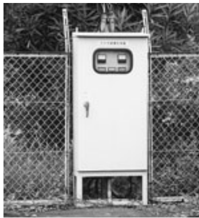
下水処理場制御盤
