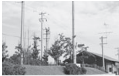
緑地公園内に新設の吹鳴装置
