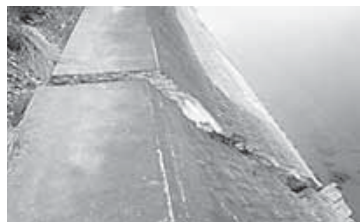
増水により損壊した勝浦川の擁壁
