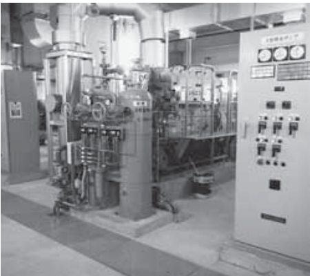
金磯南雨水ポンプ場
