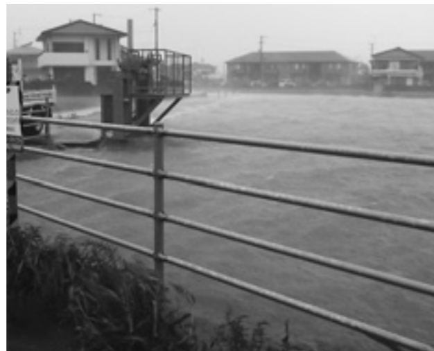
11号台風による芝生川右岸（横須南水門）付近
