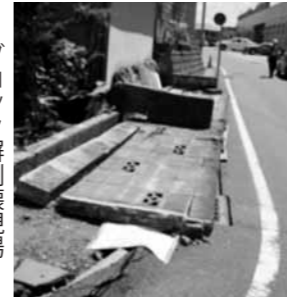
ブロック塀倒壊現場 出典・災害写真データベース
