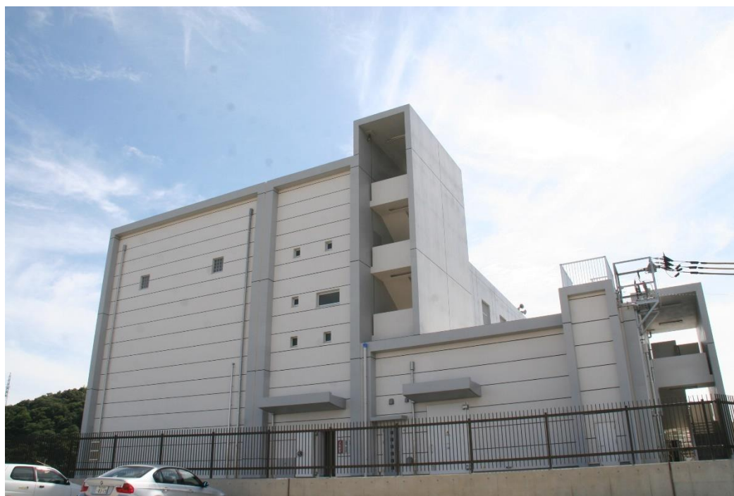
金磯南雨水ポンプ場
