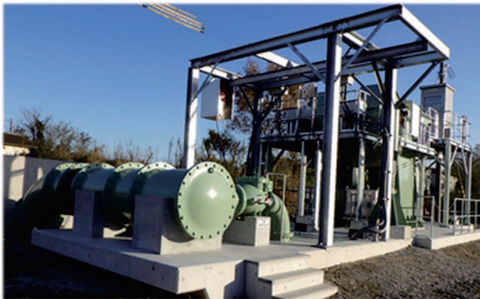
日の出内水ポンプ場
