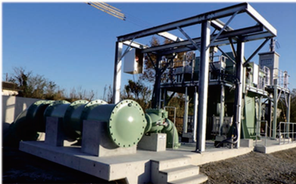
日の出内水ポンプ場
