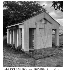
専用道路の既設トイレ
