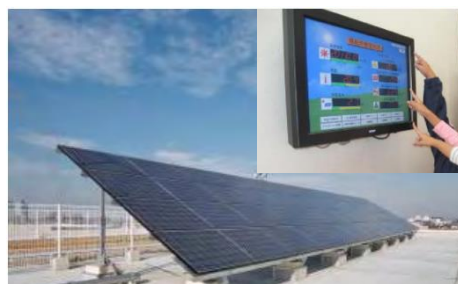
図 4-11 太陽光発電設備・発電量パネル (文科省：エコスクール・パイロットモデル事業事例集)
