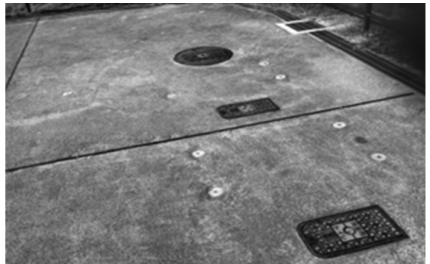
工地（たくむじ）いのち山のマンホールトイレ
