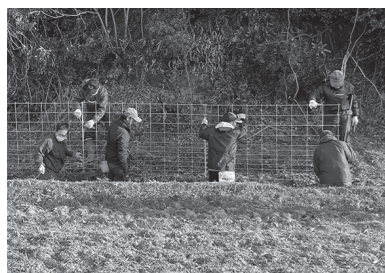
イノシシ侵入防止柵
