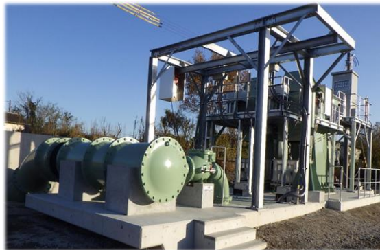
日の出内水ポンプ場【和田島町】
