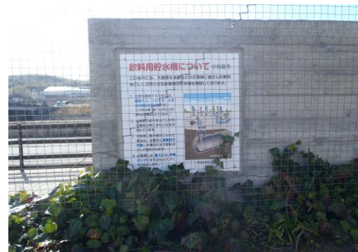
非常用耐震性貯水槽（小松島南中学校）
