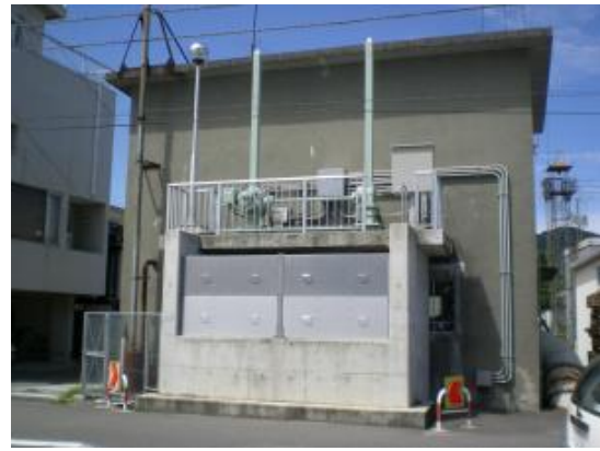
外開雨水ポンプ場
