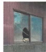
窓が割れた管理不全空家
